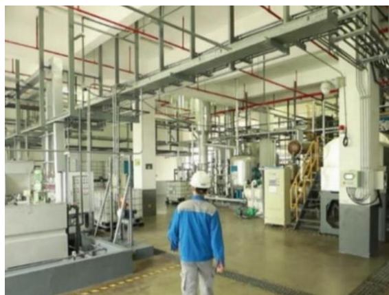
图 13 艺康太仓工厂污水处理站
